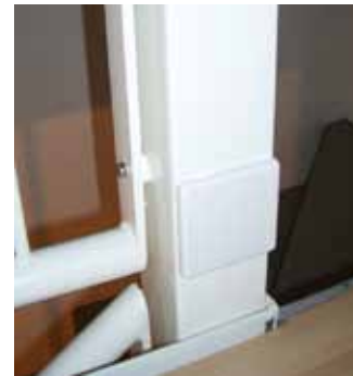
visible dans le poteau d'escalier
