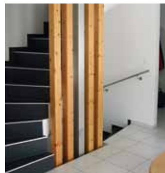
visible dans le poteau d'escalier
