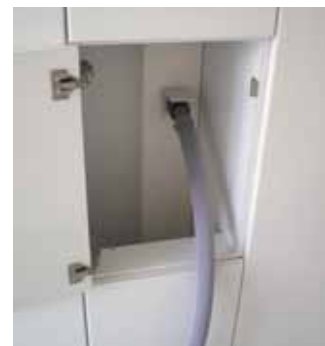
invisible dans le système central de collecte du linge existant
